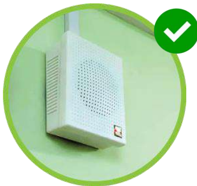
Аудиотрансляция в здании (при необходимости)
